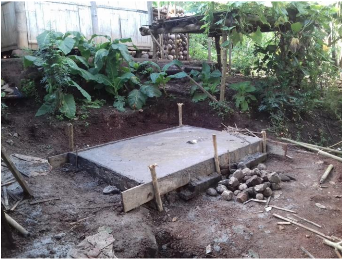
Er wordt een vloer gestort en een septic tank in de grond geplaatst.
